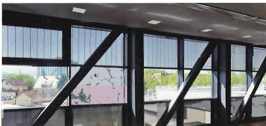
Abb. 1: Gebäudeintegrierte Photovoltaik als Fassadenbauteil: teiltransparente Photovoltaik-Module PV-Shade® in Fensterfront
